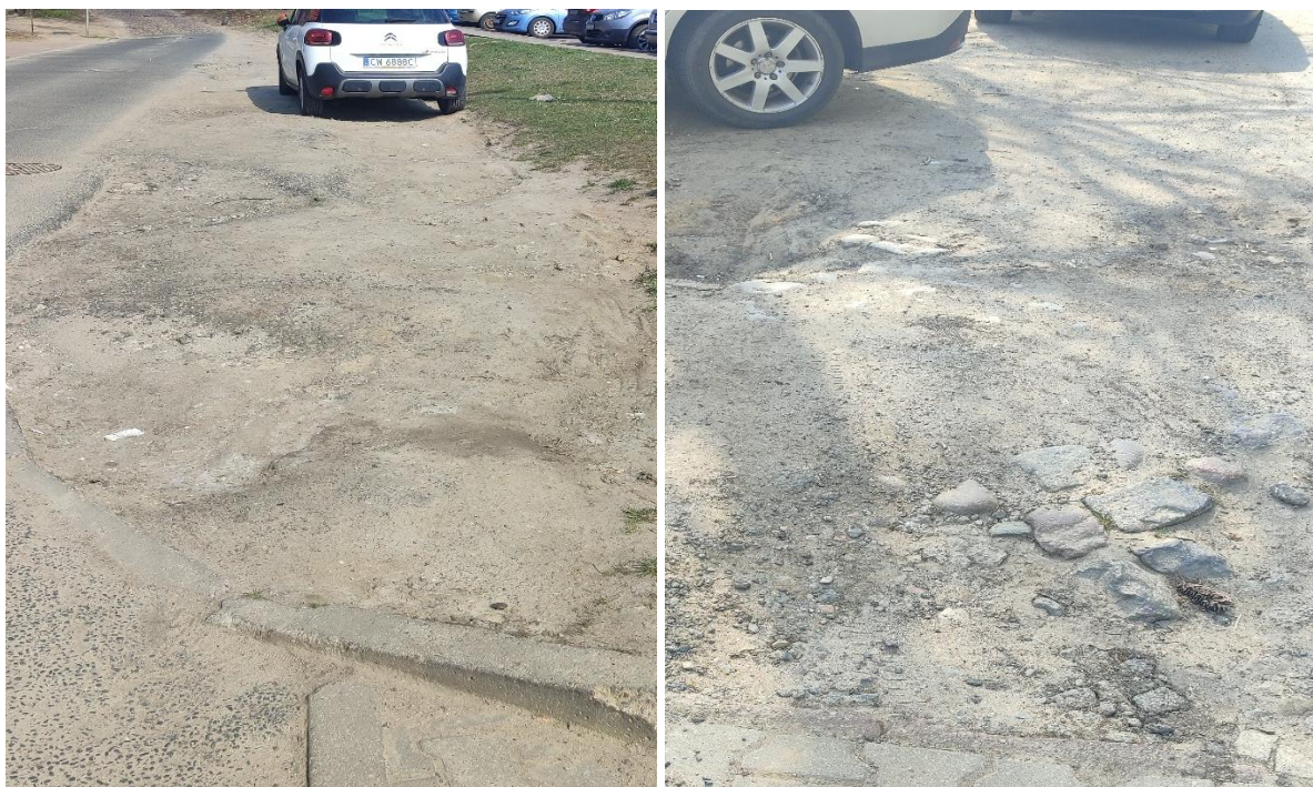
obraz 17 Ubytki pobocza - Ostrowska 9A, wjazd na parking
