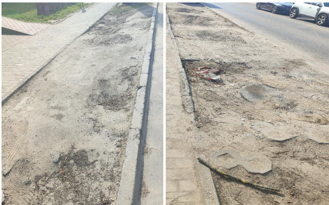
obraz 20 Ubytki pobocza Ostrowska od 6 do 10 - za znakiem B-36
